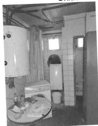
Technická miestnosť s hygienickým zariadením
