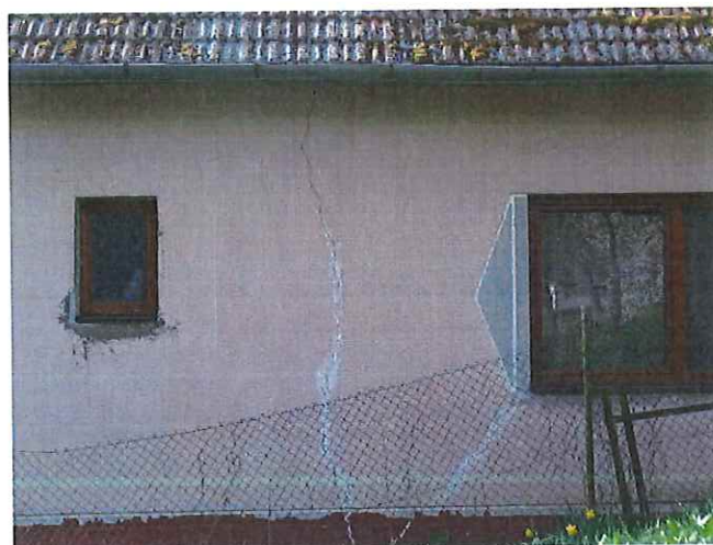
Trhliny na rodinnom dome s.č.2496
